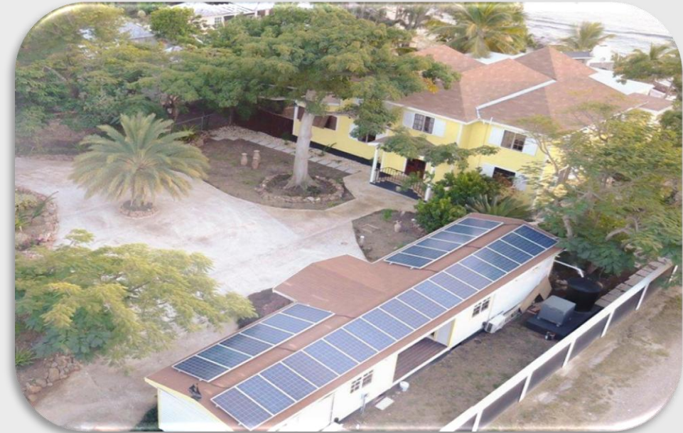
150KW Solar System Antigua 2018
